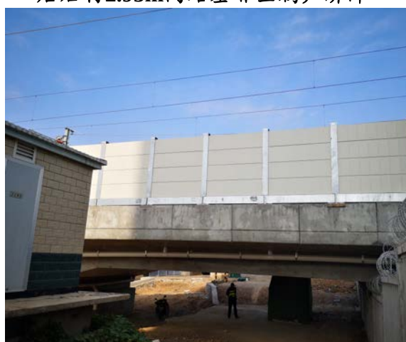
在建翡翠湾小区2.3m高桥梁金属声屏障
