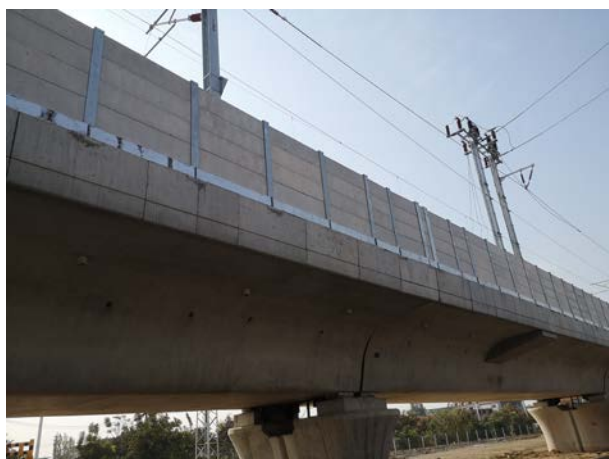
店后村2.3m高桥梁非金属声屏障
