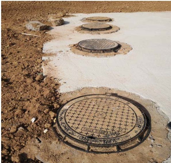
焦作西站化粪池
