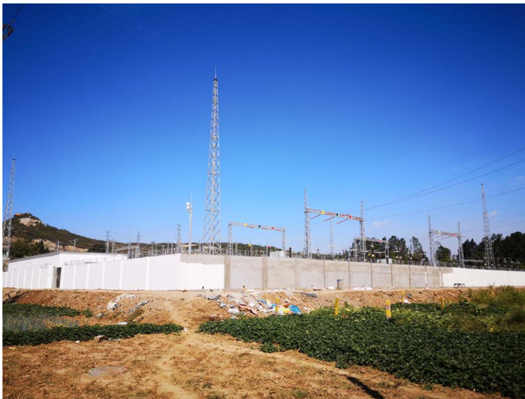
博爱牵引变电所
