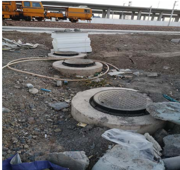
焦作西站动车存车场厌氧反应池
